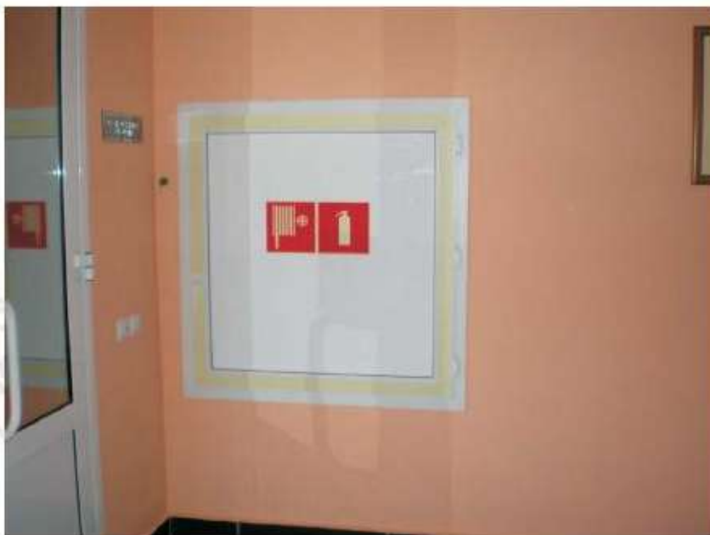
Рисунок А.6 — Обозначение фотолюминесцентной 50-мм лентой контура пожарного оборудования и использование знаков пожарной безопасности
